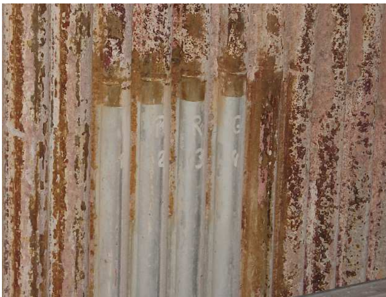
Fragment ekranu kotła elektrowni częściowo pokryty powłoką ochronną po określonym czasie eksploatacji
